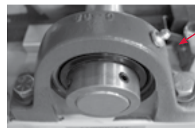
FIGURE 23. Inspectez le collier de roulement pour vous assurer que tous les boulons et
