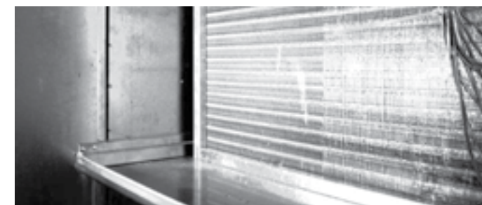
FIGURE 29. Les serpentins de refroidissement doivent être vérifiés pour détecter toute fuite pendant le fonctionnement.
