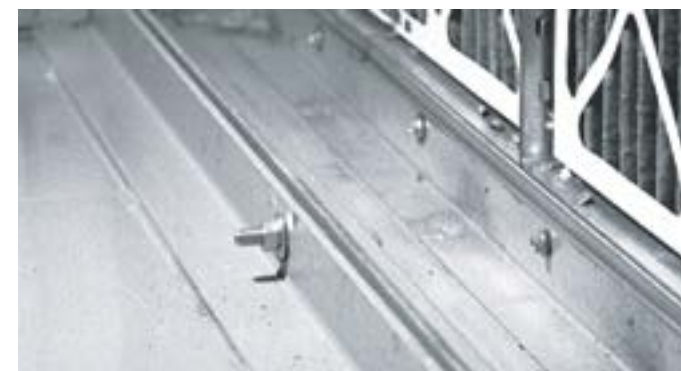
FIGURE 9. Raccord situé au plancher.
