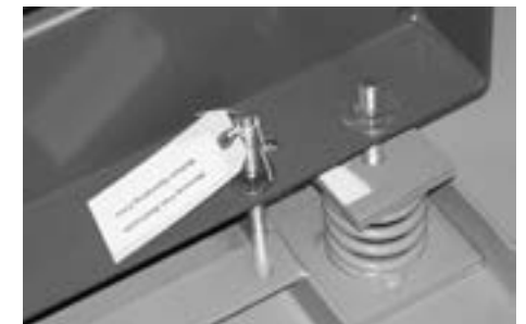
FIGURE 17. Deux dispositifs de retenue à la base de l'arrière du ventilateur.
