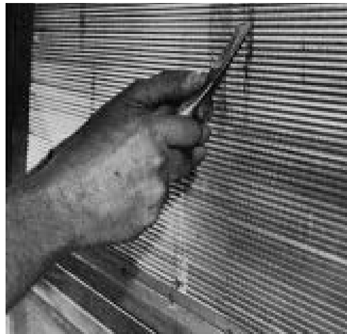
FIGURE 27. Un peigne à ailettes peut être utilisé pour enlever la matière enchevêtrée dans les ailettes, ainsi que pour redresser les ailettes. Mais normalement, rincer les serpentins avec de l'eau sous pression normale enlèvera la plupart des matières.
