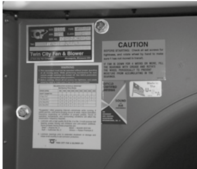
FIGURE 26. L'étiquette de lubrification pour les ventilateurs de plus grande taille est située sur le boîtier d'entrée du ventilateur. *Le modèle/la marque du ventilateur peuvent varier en fonction du projet.
