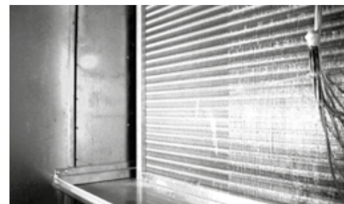
FIGURE 29. Les serpentins de refroidissement doivent être vérifiées pour détecter les fuites pendant le fonctionnement.
