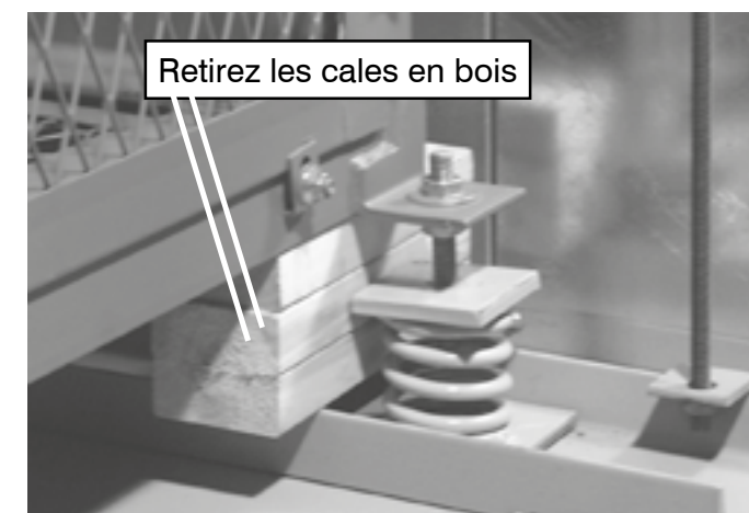
FIGURE 25. Dispositifs de retenue du ventilateur situés à la base du ventilateur.
